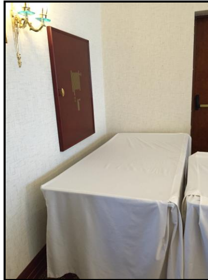
Resim 4.14. B oteli toplantı salonu katında yangın dolabı önüne yerleştirilmiş masa
