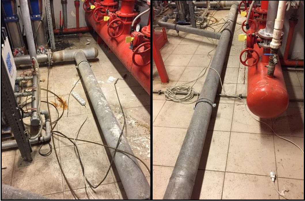
Resim 4.1. Yangın pompa odası
