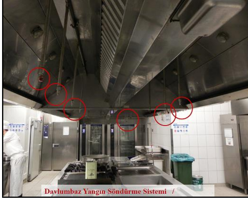
Resim 4.12. A oteli davlumbaz otomatik yangın söndürme sistemi
