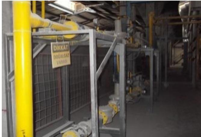
Resim 4.16. Fırın bölümü doğalgaz hattı
