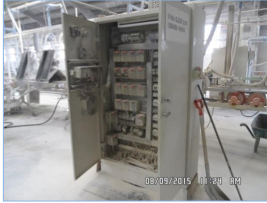
Resim 2.17. Pano kapaklarındaki uygunsuzluk
