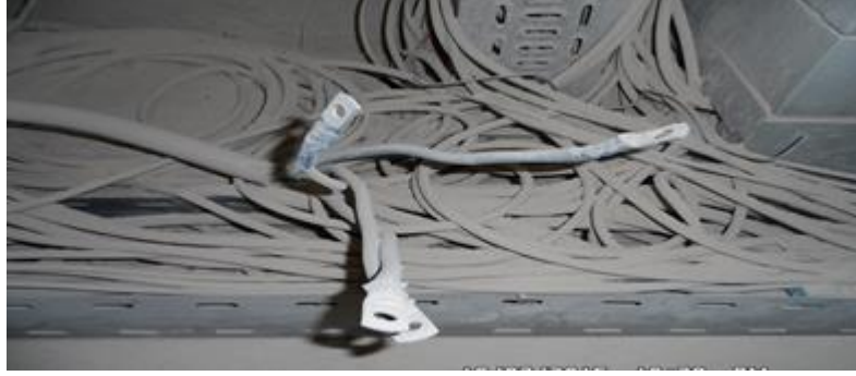
Resim 4.1. Dağınık halde bulunan elektrik kabloları
