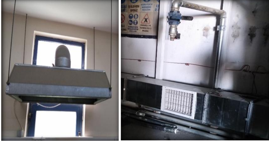
Resim 4.14. Çeker ocak ve yerden havalandırma sistemi
