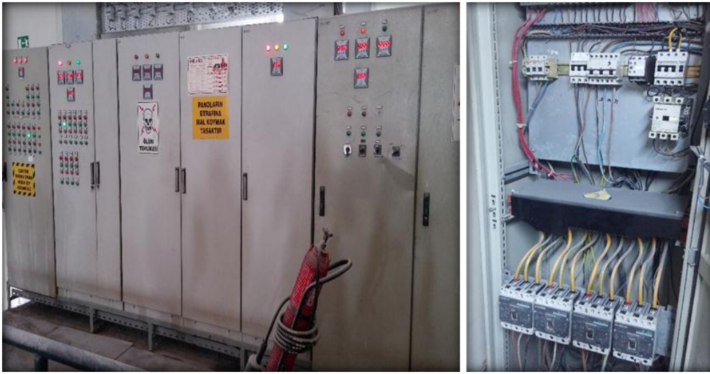
Resim 4.10. Önünde engel bulunan pano (solda), kapağı açık bırakılmış pano (sağda)
