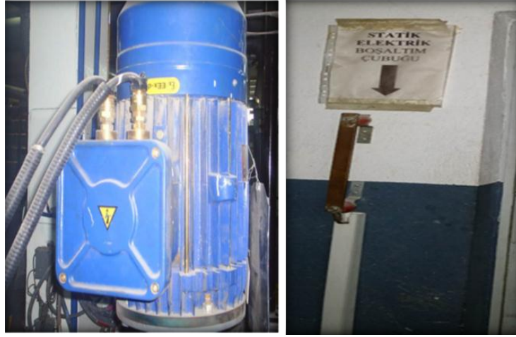
Resim 4.20. Exproof bir karıştırma makinası motoru [16] (solda), statik elektrik boşaltım çubuğu
