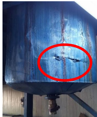
Resim 4.7. Korozyona uğramış kazan
