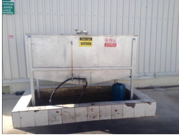
Resim 4.34. Motorin Tankının Kontrolsüz Şekilde Ulaşılabilir Olması
