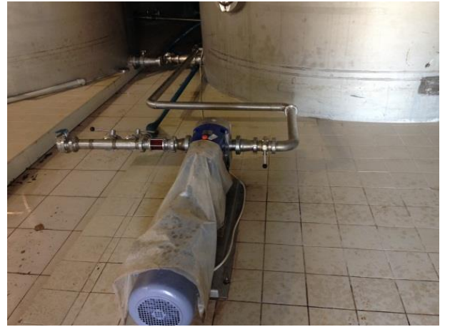
Resim 4.30. Koruyucu Kapaksız Motor
