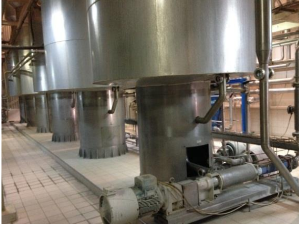
Resim 4.27. Koruyucu Kapaksız Motor
