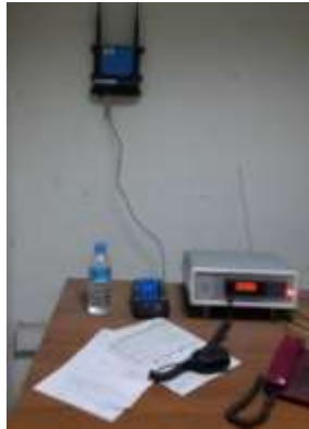
Resim 4.1. Yeraltında bulunan sabit telefon hattı ve telsiz sistemi
