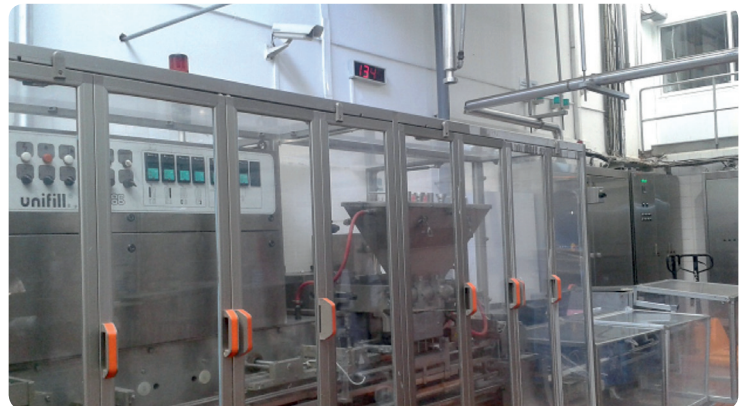
Şekil 17: Makinenin tamamının koruyucular ile izole edilmesi
