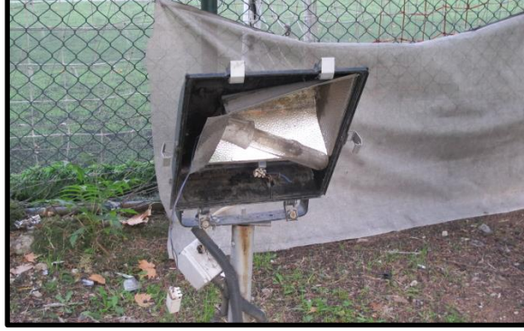
Resim 4.44. Hasarlı aydınlatma elemanı
