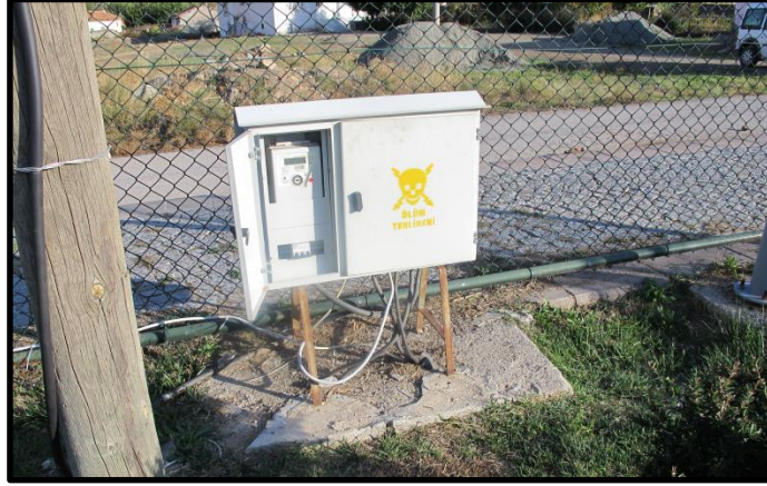
Resim 4.46. Kapağı açık bırakılmış elektrik panosu
