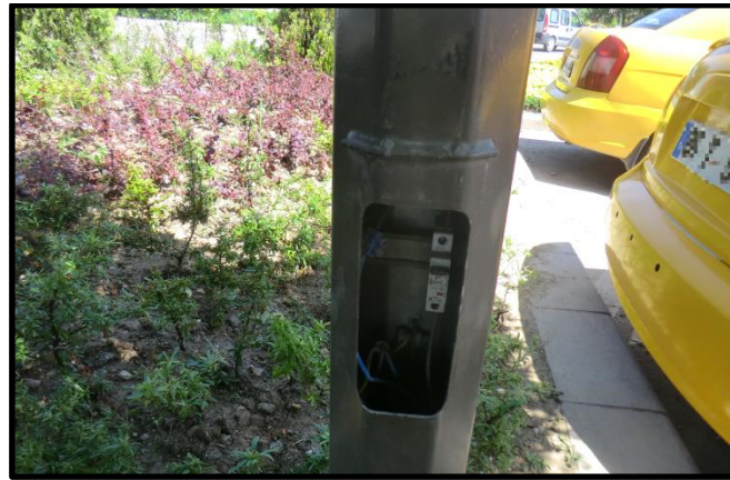
Resim 4.45. Kabloları açıkta duran elektrik direği
