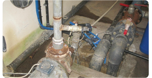
Resim 17. Islak zemine temas eden elektrik kabloları
