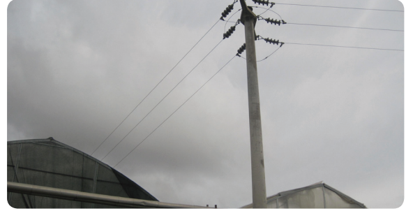
Resim 15. Sera yakınında elektrik hattı
