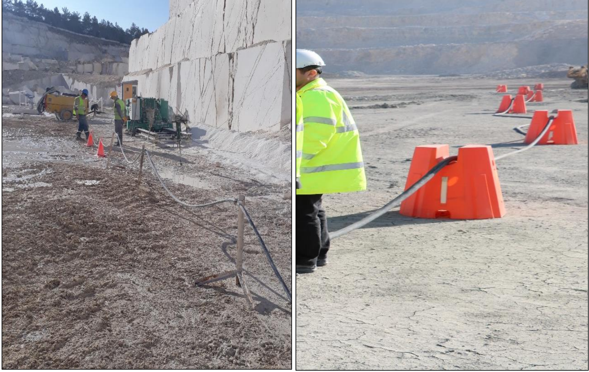
Resim 3.4- Ocak içerisinde elektrik kablolarının ıslak zemine temasını engellemek için yapılan uygulamalar
