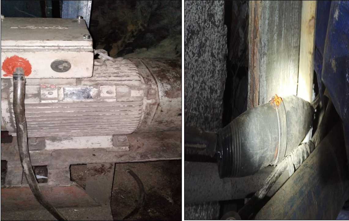
Resim 3.7- Kömür ocağında exproof motor ve kablolarda sızdırmazlık uygulamaları yapılmıştır.
