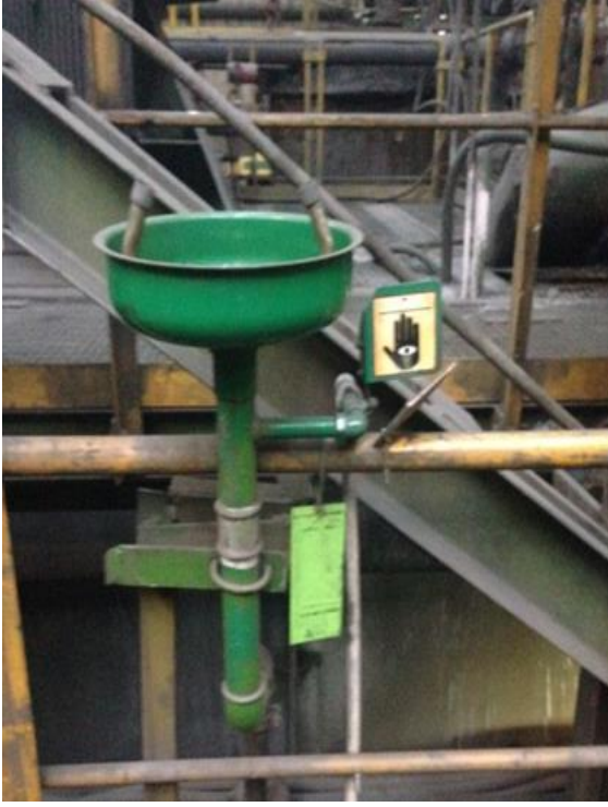
Resim 2.9. Göz yıkama istasyonu
