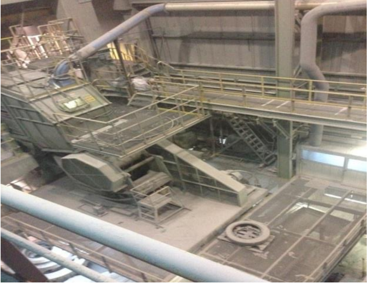
Resim 2.5. Kırma ünitesinde toz problemi
