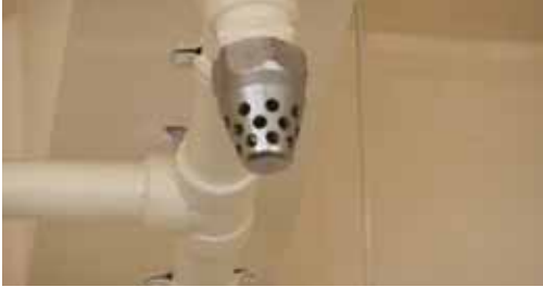
4.31 Yangın Algılama Sistemine Bağlı Çalışan Springler
