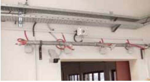
4.29 Alev Dedektörüne Bağlı Çalışan Yangın Söndürme ve Kontrol Sistemi
