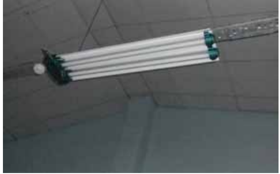
4.22 Explosion Proof Aydınlatma Sistemi ve Duman Algılama
