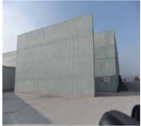
4.2 Beton Sütreler ve Kamera Kontrol Sistemi
