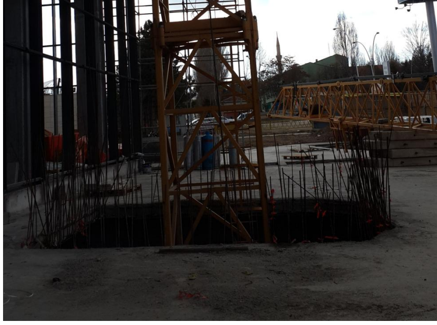
Şekil 46. Kule vinç boşluğu ve açıkta bırakılan demirler
