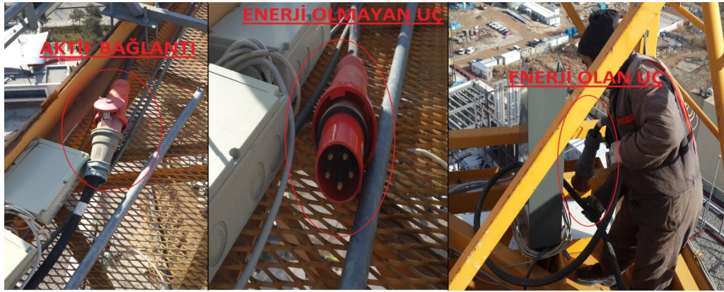
Şekil 49. Elektrik kaynaklı tehlikeler
