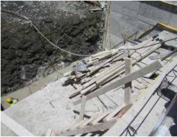
Platform Kenarında Düşme Riski Bulunan Malzemeler
