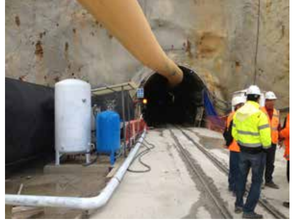
Tünel İçerisine Havalandırma Tesisatı (Teftiş Sonunda)
