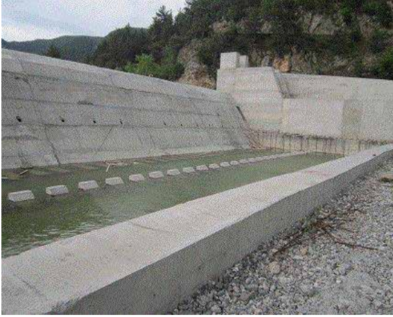
Betonarme Platform Kenarları (Teftiş Başlangıcında)
