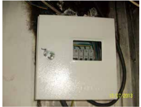
Pano İçine Alınmış Elektrik Tesisatı (Teftiş Sonunda)
