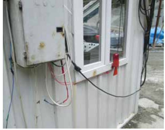
Santral Binası İnşaatı Yakınında Acil Durum Alarm Tertibatı
