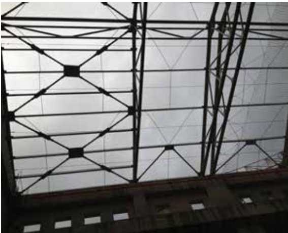
Yeterli Koruma Önlemi Alınmamış Çatı Çalışmaları (Teftiş Başlangıcında)
