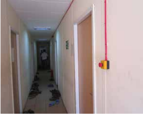
Koşuylarda Acil Durum Alarm Sistemi
