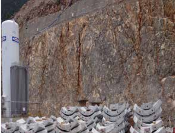
Depolama Alanında Taş/Kayaç Düşme Riski (Teftiş Başlangıcında)
