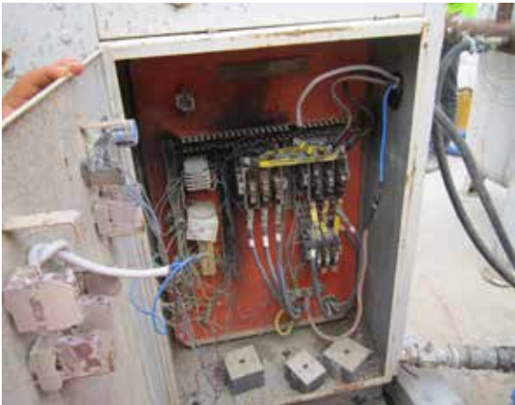
Koruma Altına Alınmamış Elektrik Tesisatı (Teftiş Başlangıcında)
