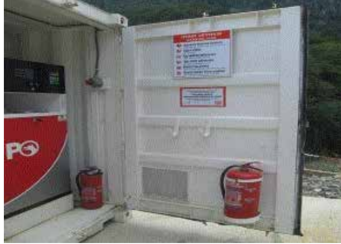
Pompa Yakınında Alarm Tertibatı
