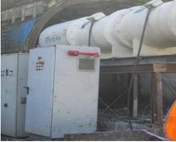
Tünel Girişinde Alarm Sistemi
