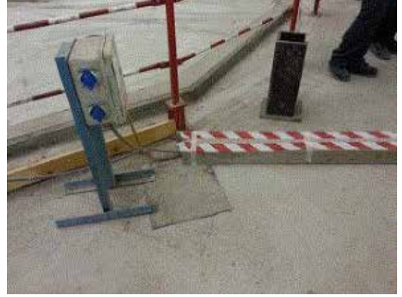
Kanal İçerisine Alınmış Kablolar
