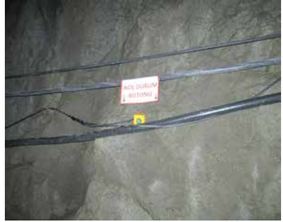
Tünel İçinde Alarm Sistemi
