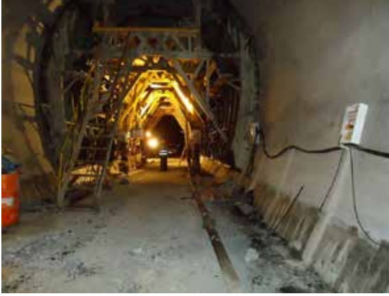
Askıda Taşınan Elektrik Kabloları
