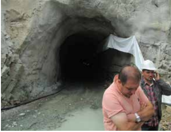
Havalandırması Sağlanmayan Tünel (Teftiş Başlangıcında)
