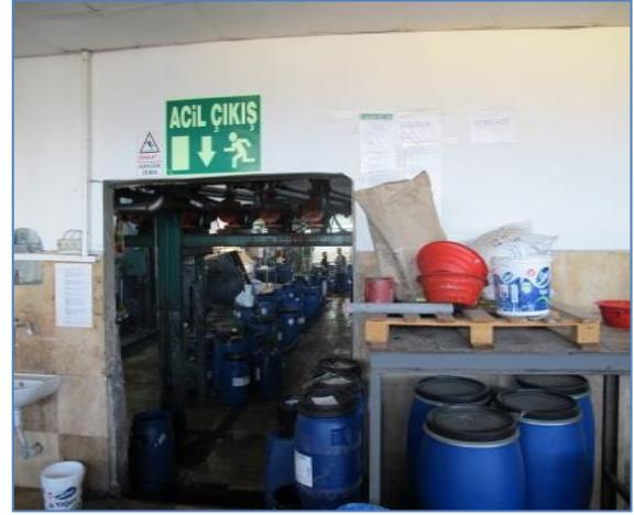
Şekil 4.84. Uygun olmayan acil kaçış yolu
