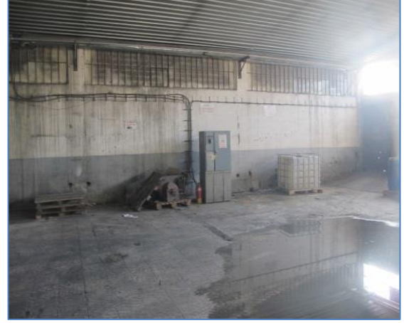
Resim 4.80. Uygun olmayan elektrik panosu
