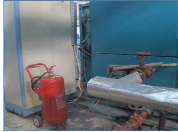
Resim 4.78. Ramöz bacası yangınında kullanılmak üzere arabalı yangın söndürme cihazı
