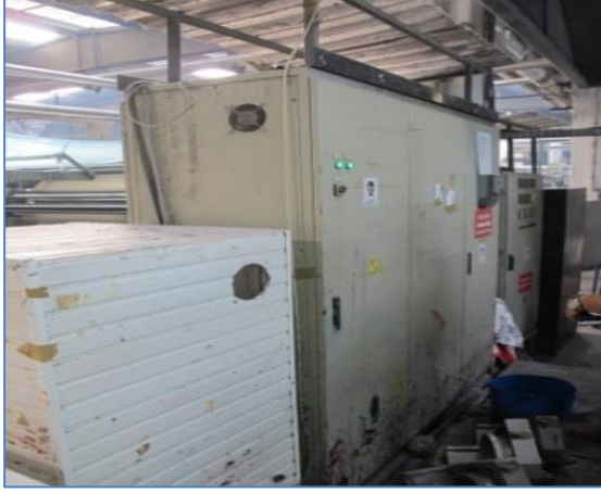
Resim 4.79. Uygun olmayan elektrik panosu
