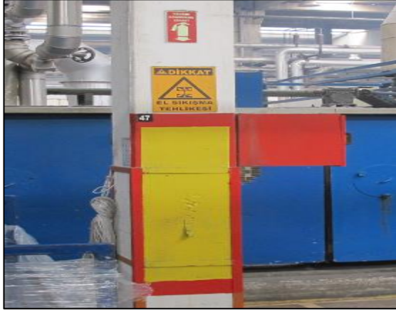
Resim 4.81. İşaretli alanda yangın söndürme cihazı bulunmaması
