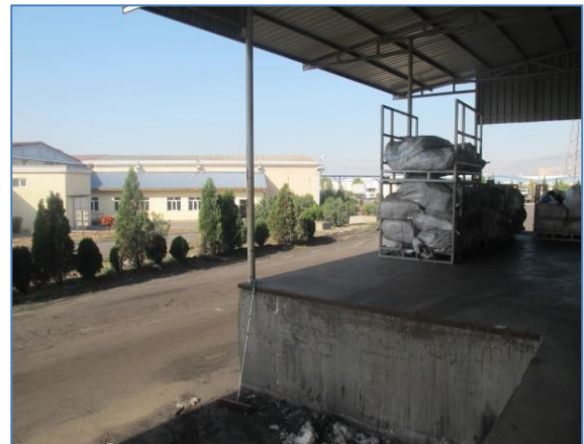
Resim 4.64. Korkuluk bulunmayan yükleme rampası
