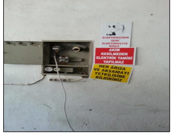
Resim 4.13. Uygun olmayan elektrik panosu
