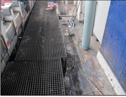
Resim 4.49. El aletlerine ait kabloların yerde bırakılması
