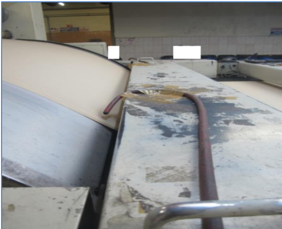
Resim 4.59. Korkuluğu bulunmayan rotasyon baskı geçiş yolu
