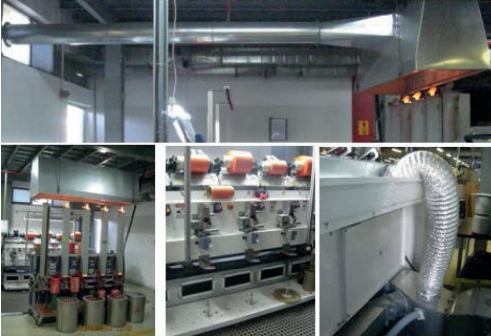
Resim 11. Makine üzerlerine ve altlarına yerleştirilmiş olan emiş sistemleri.
