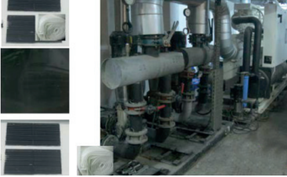
Resim 14. Düzenli bakım yapılan verimli çalışan klima tesisleri.
