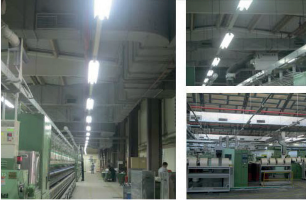
Resim 16. Tavandaki temiz hava kanalları.
