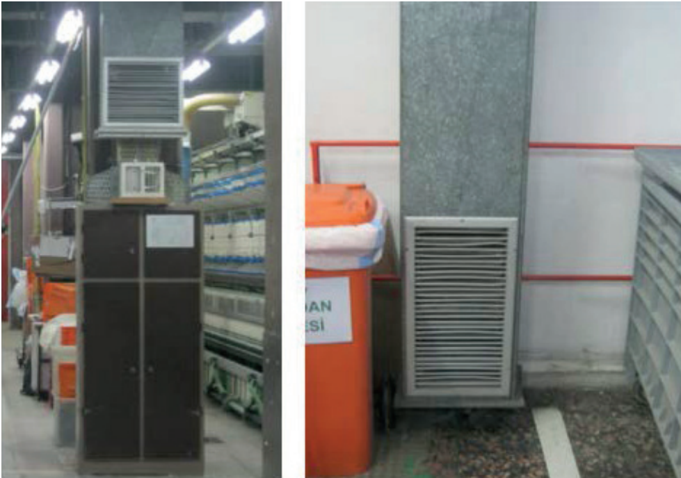
Resim 17. Kolonlarda yer alan temiz hava kanalları.
