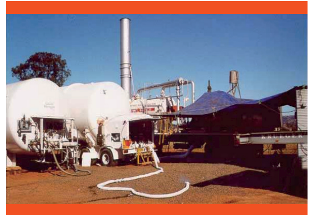
Şekil 6.2 Bir maden sahasında kurulu Mineshield inertizasyon tesisi (Gillies ve Wu, 2007).
