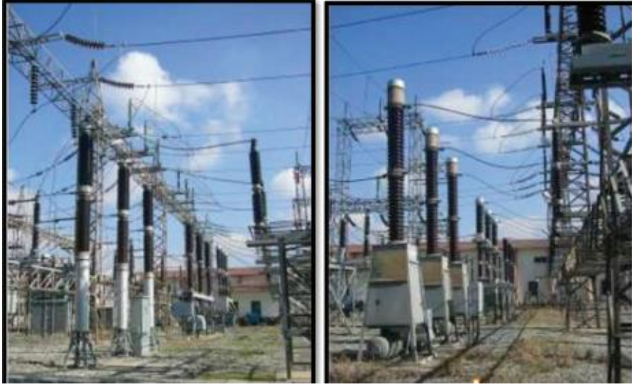
Şekil 2.7: SF 6 Gazlı ve Havalı 154 kV Kesici 5
