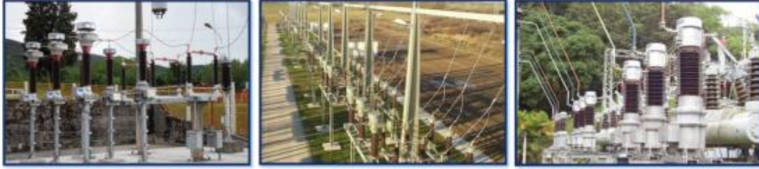
Şekil 2.8: Açık Şalt Sahası 5
