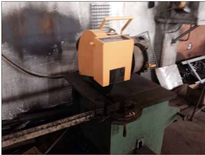
Şekil 4 - Makine ve Ekipmanlarda Hareketli Kısımlara Yapılan Koruyucu Örnekleri
