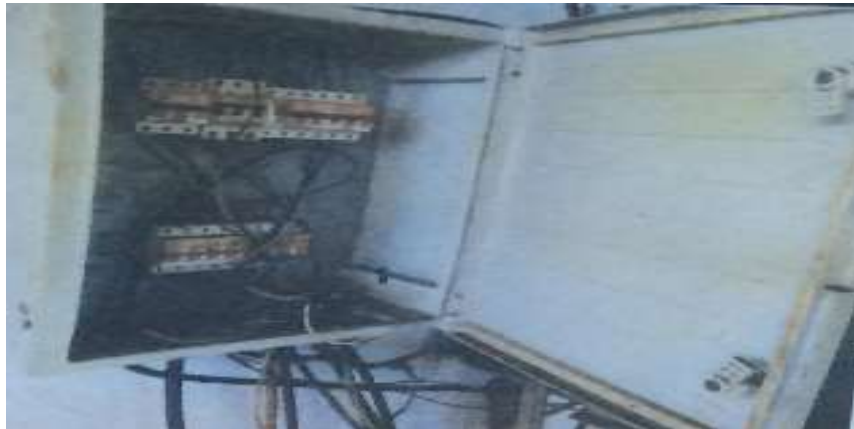
Resim 4.15. Kapağı Açık Halde Olan Elektrik Panosu
