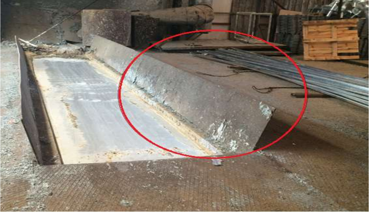
Resim 4.5. Düşmeyi Önleyici Uygun Bariyer Bulunmayan Açık Havuz
