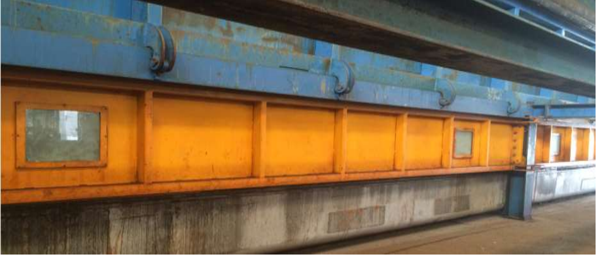
Resim 4.10. Kapalı Sistem Sıcak Daldırma Havuzu
