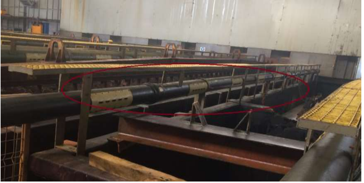
Resim 4.12. Asit Havuzu Kenarındaki Havalandırma Sistemi
