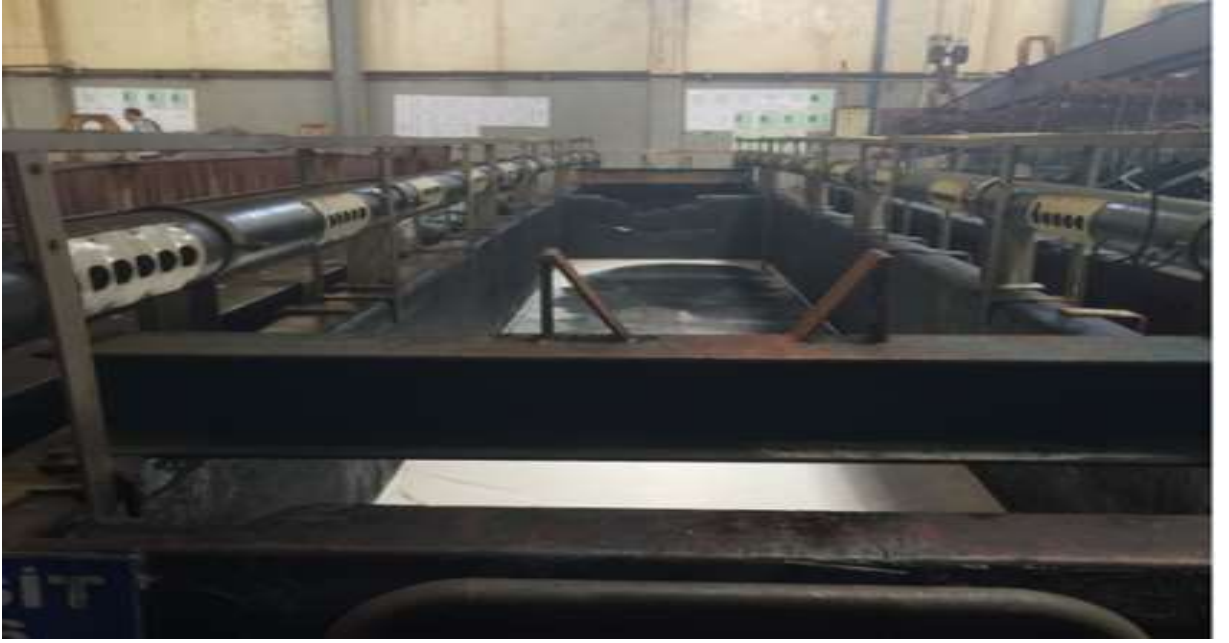
Resim 2.8. Asitle Dađlama Havuzu
