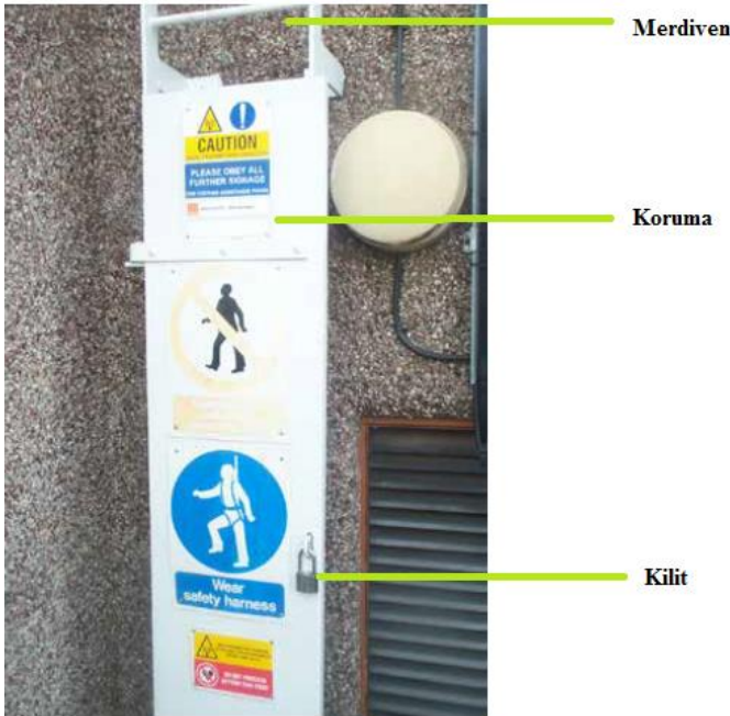
Şekil 4.2. Güçlü alanlara erişimi kısıtlamak için çatıda merdiven korumasının kullanılması
