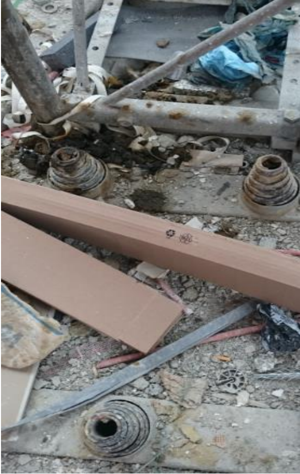
Resim 11. Cephe asansörünün tamponlarının yer aldığı zeminin uygunsuzluğu durumu
