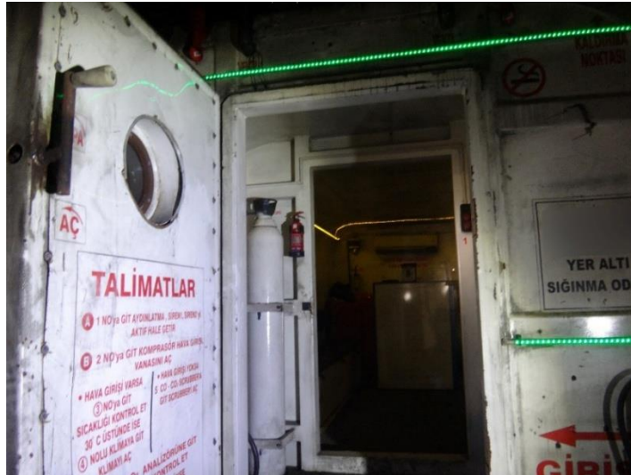
Şekil 4.20. Taşınabilir sığınma odasının kapısı
