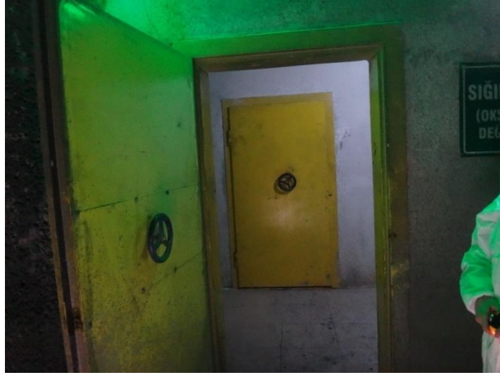
Şekil 4.19. İşletmede bulunan sabit sığınma odalarının kapısı
