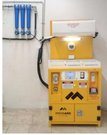
Şekil 4.29. Sabit sığınma odasında bulunan gaz temizleme ekipmanı
