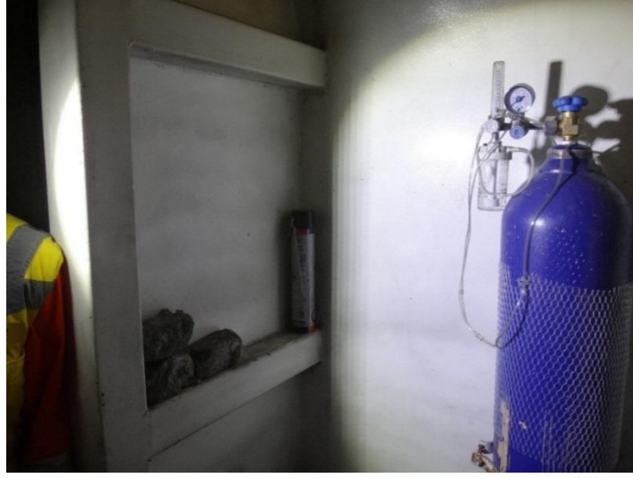
Şekil 4.22. 14 kişi kapasiteli taşınabilir sığınma odasında bulunan O 2 tüpü
