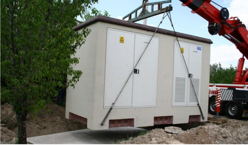
Şekil 5. Beton köşk tipi trafo merkezi [13]
