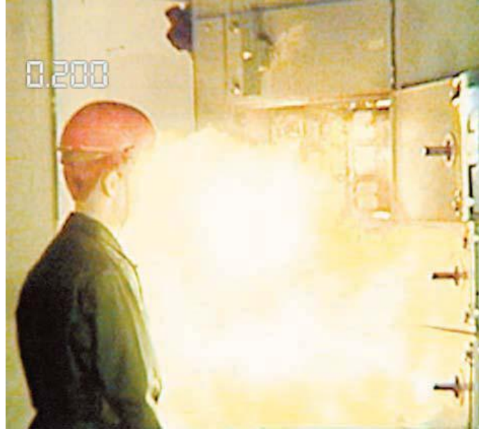
Şekil 31. Panoda çalışma sırasında oluşan ark
