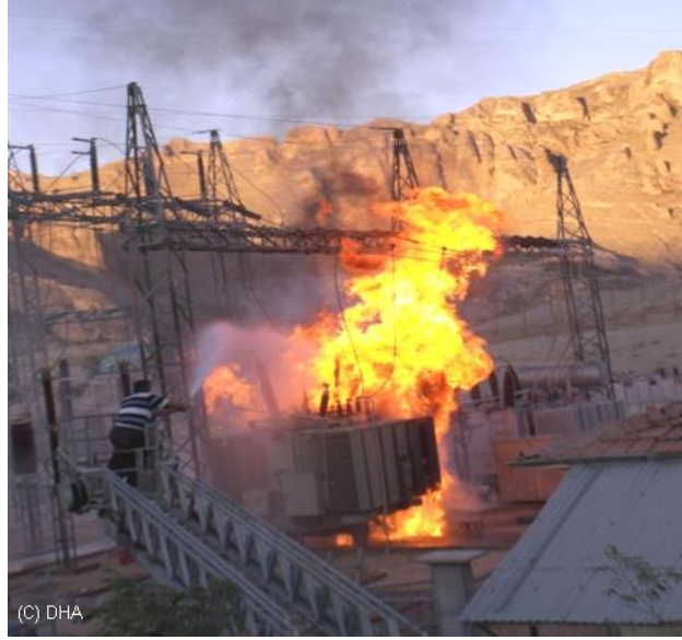
Şekil 34. Trafo merkezi yangını
