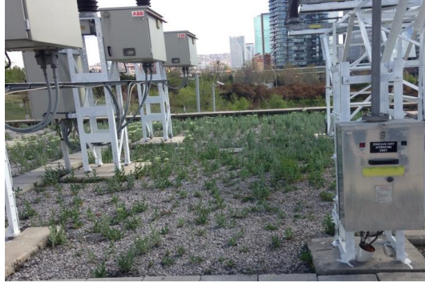
Şekil 26. Açık şalt sahasında bulunan otlar
