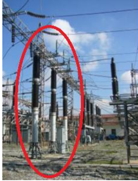
Şekil 10. 154 kV SF6 gazlı kesici
