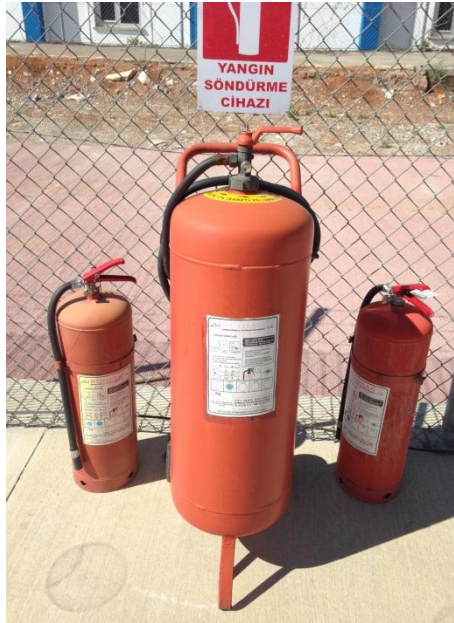
Şekil 35. Açık şalt sahasında bulunan yangın tüpleri
