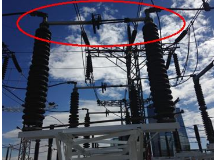
Şekil 11. Açık şalt sahasında kullanılan ayırıcılar
