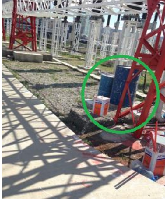
Şekil 27. Açık şalt sahasında bulunan boya kutuları
