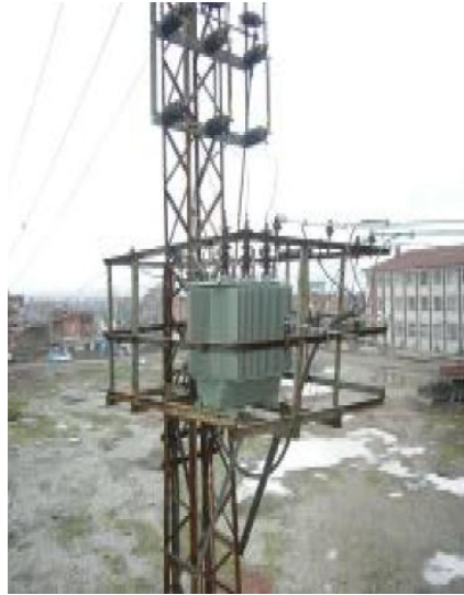
Şekil 3. 250 kVA demir trafo direği ve platformu [13]
