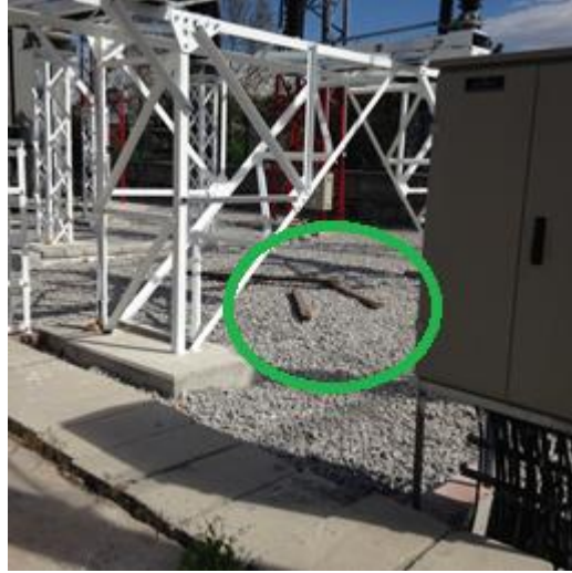
Şekil 28. Açık şalt sahasında bulunan tahta parçaları
