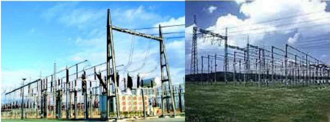
Şekil 8. Açık şalt sahası [13]
