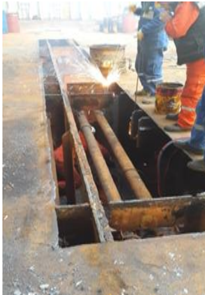
Resim 4.2. Yakıt tankında çalışmaya başlamadan önce boruların gazdan arındırılmaması ve devrelerin körlenmemesi
