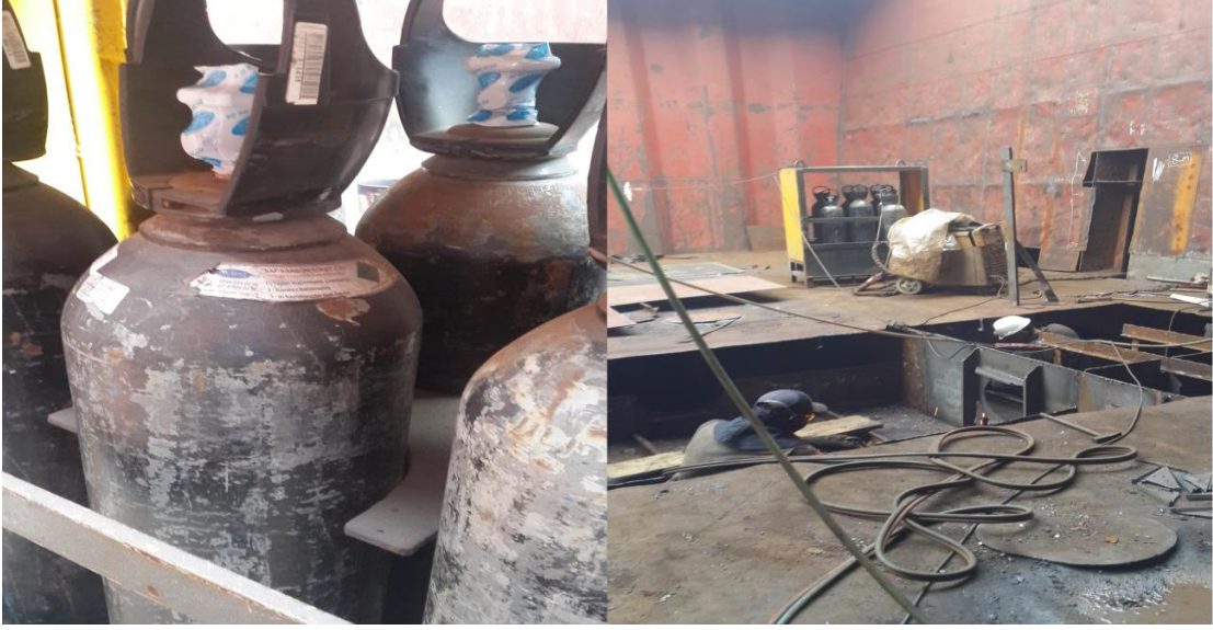
Resim 4.8. Şaloma tüplerinin kapalı alanına indirilmesi, uygun tanımlamanın yapılmaması, şaloma tüpleri ve kablolarının elektrik kaynağı ile yakın olması
