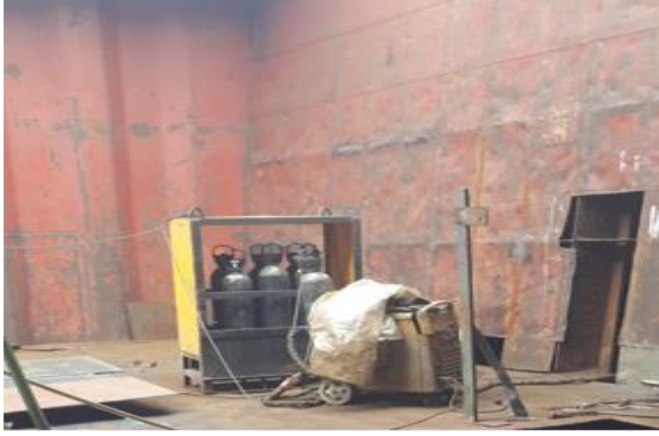
Resim 4.6. Bakımları yapılmamış jeneratör
