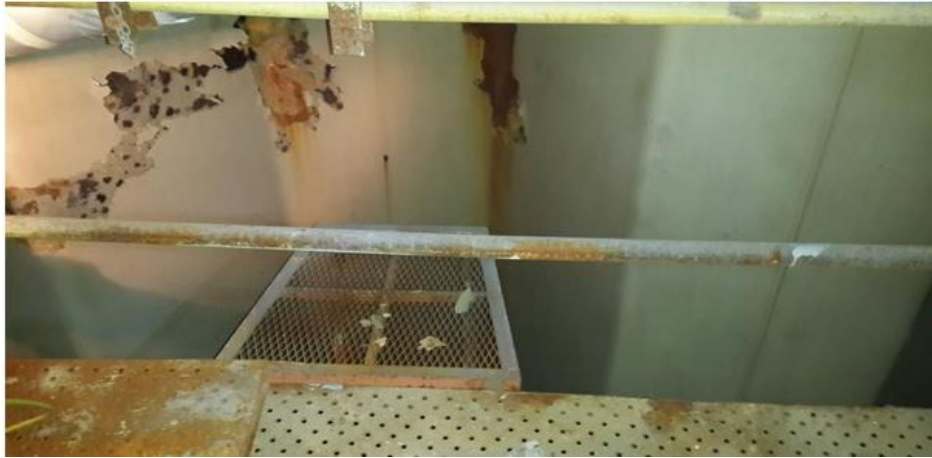
Resim 4.12. İskelenin duvara tam yanaştırılmaması ve topuk levhasının olmaması, köşe platformlarında korkuluk olmaması
