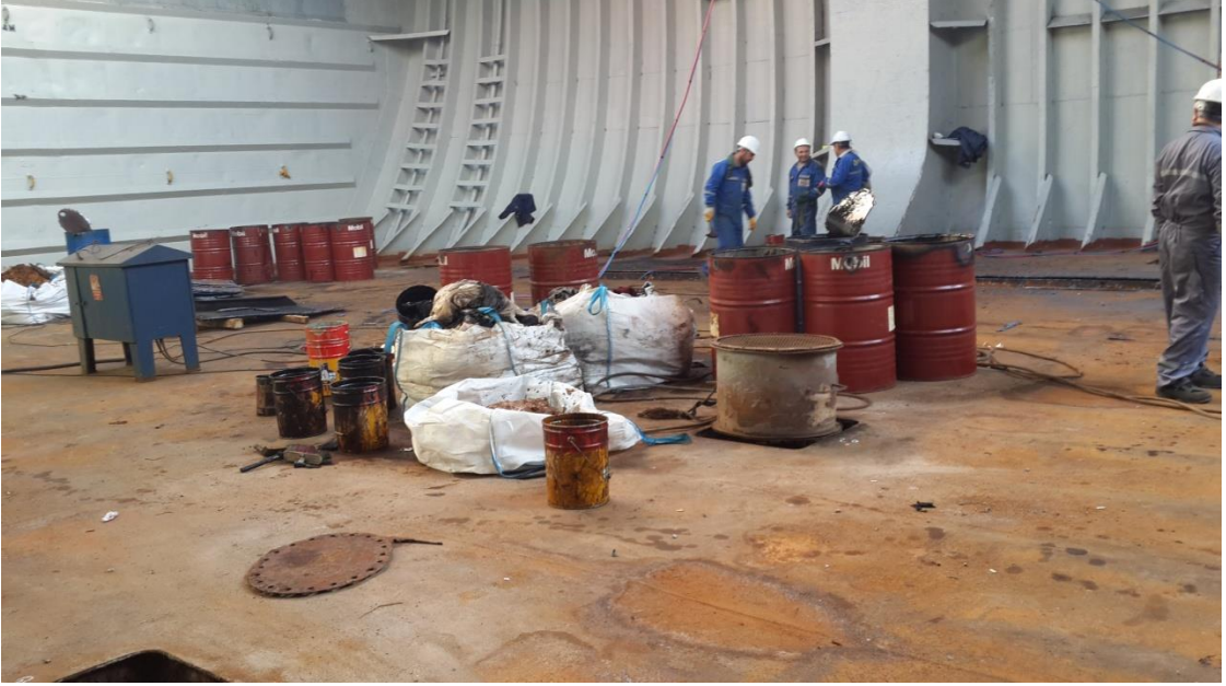
Resim 4.1. Yakıt tanklarının girişlerinde uyarı işaret ve levhalarının bulunmaması
