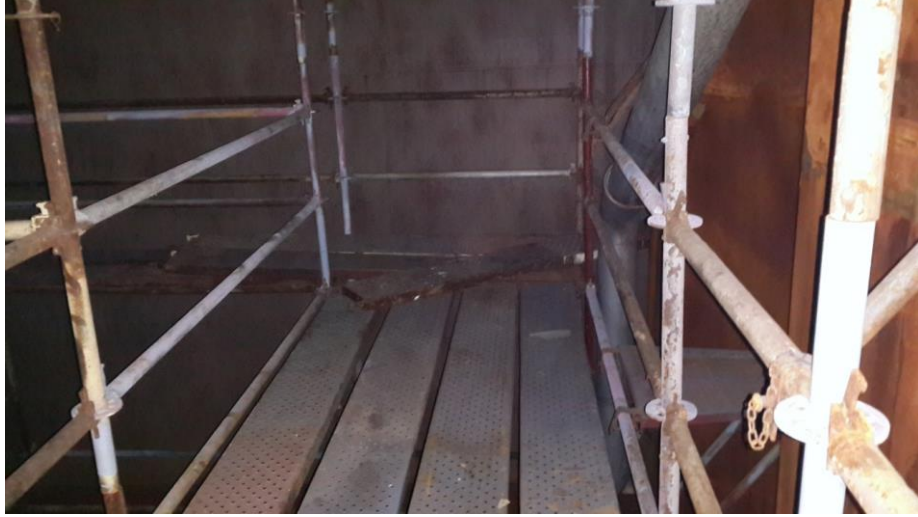
Resim 4.11. Uygun olmayan iskele
