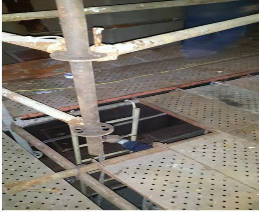
Resim 4.13. İskelede açıklıkların olması ve iskele bağlantılarının sağlam olmaması
