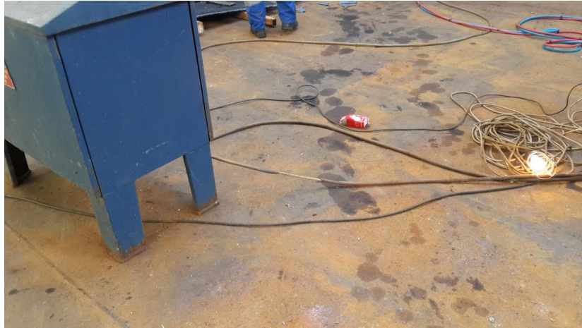
Resim 4.5. Şaloma hortumları ile elektrik kablolarının birbirine dolanması
