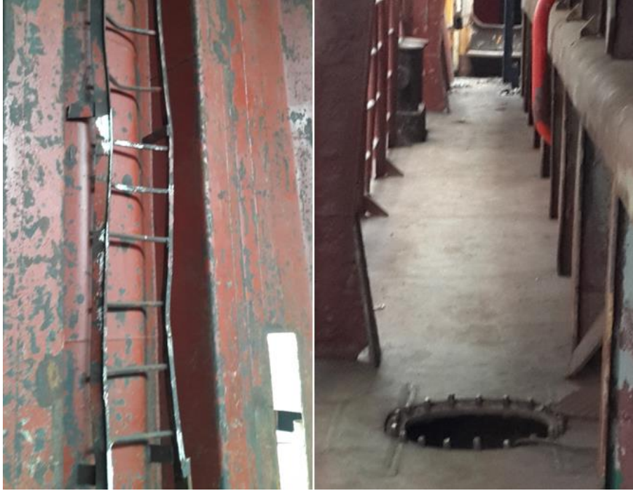
Resim 4.7. Deforme olmuş merdivenler ile etrafı çevrilmemiş menholler
