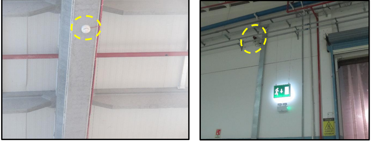
Resim 4.36. Depo alanlarında bulunan yangın sensörleri ve duman algılayıcılar
