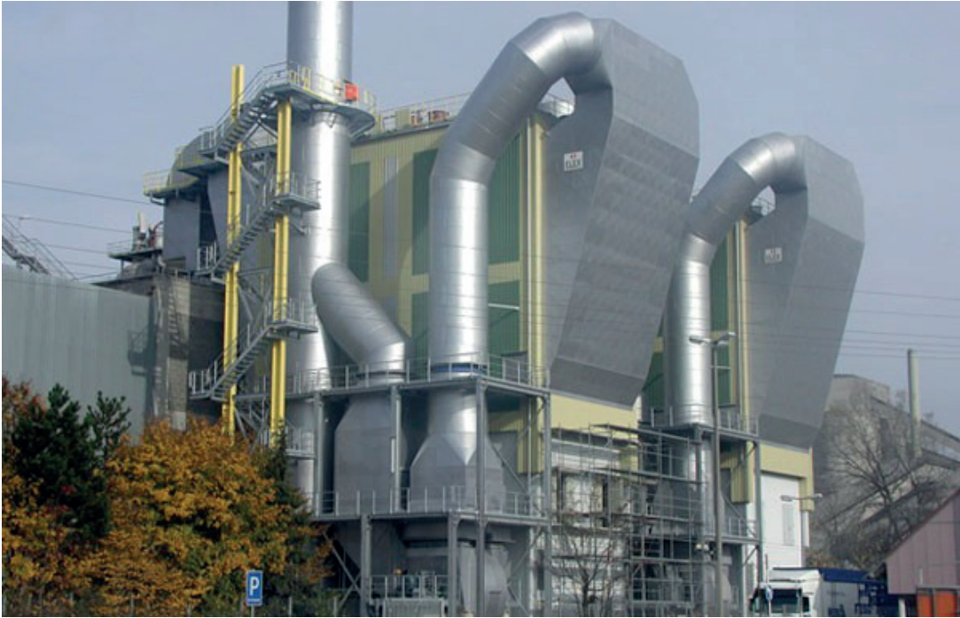
Resim 4. Elektrik alanı oluşturarak panellerde toz toplama ve üretime geri kazandırma sistemi
