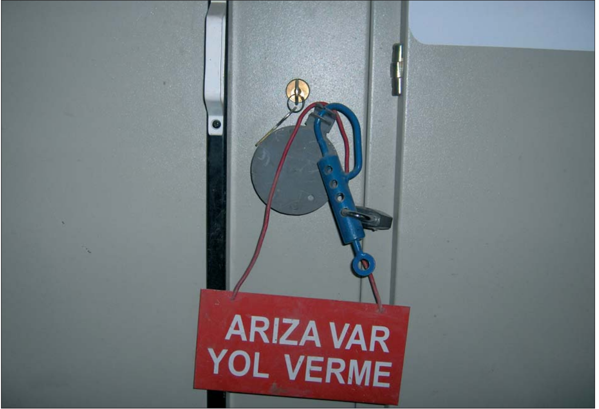
Enerji kesme uygulaması.
