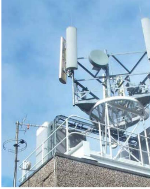
Şekil 10.1. Binanın çatısına yerleştirilmiş telekomünikasyon sektörüne ait antenler ve mikrodalga çanak
