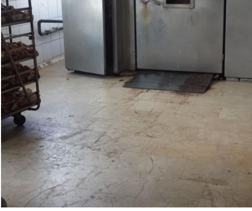
Resim 4.5. E işyerine ait bozuk ve çatlak zemin
