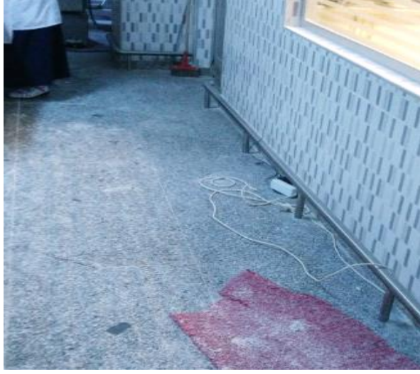
Resim 2.7. Elektrik kablolarının dađınık vaziyette bulunması
