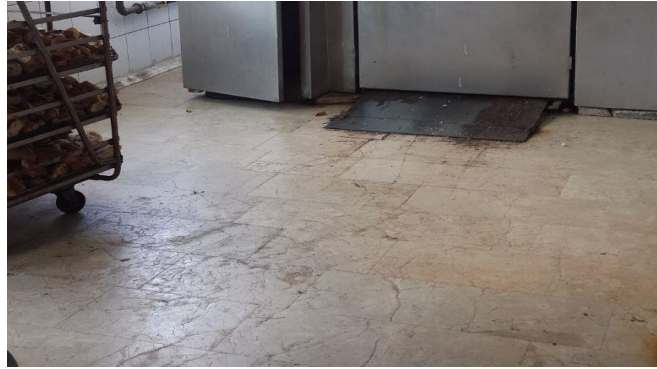
Resim 2.2. Hasarlı ve yıpranmış zemin
