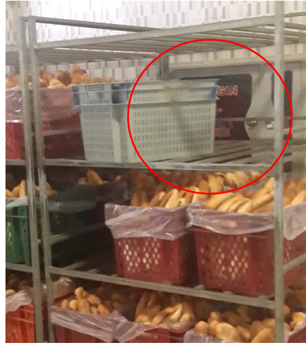
Resim 4.13. B işyerinde önüne malzeme istiflenmiş bir yangın dolabı
