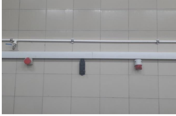
Resim 4.10. E işyerinde kapalı priz ve korunaklı elektrik kabloları
