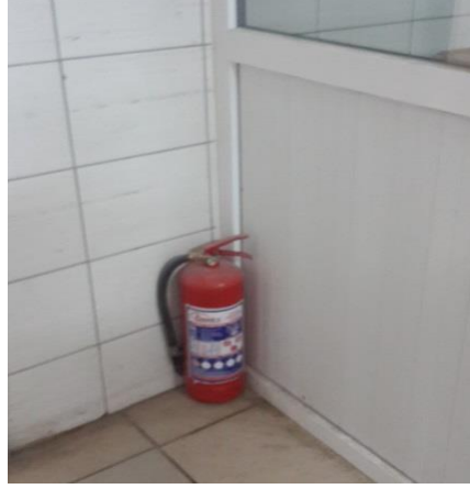
Resim 4.12.D işyerinde konumu işaretlenmemiş yangın söndürme tüpü
