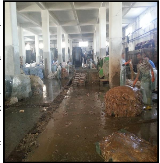
Tıkanan atık hattı
