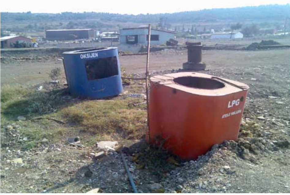
Oksijen ve SPG ara dağıtım istasyonları
