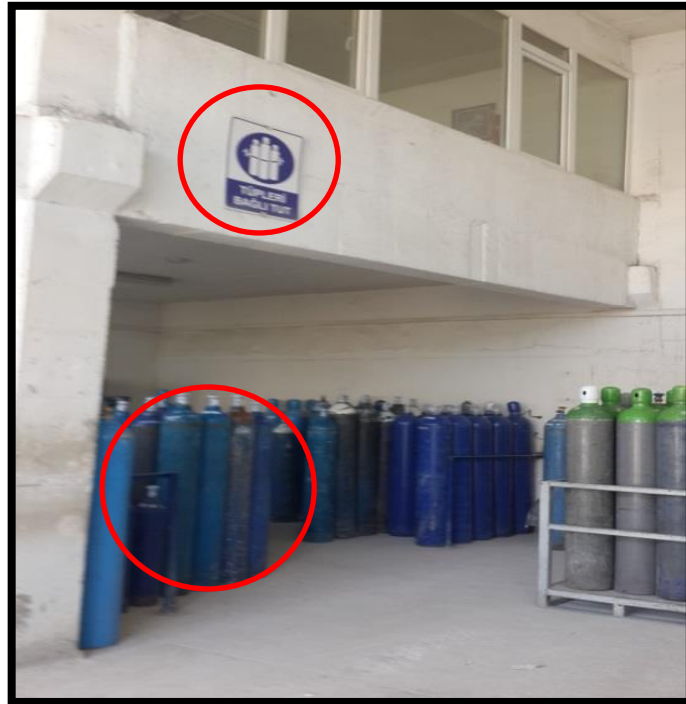
Resim 4.1. Gaz tüplerinin sabitlenmemesi
