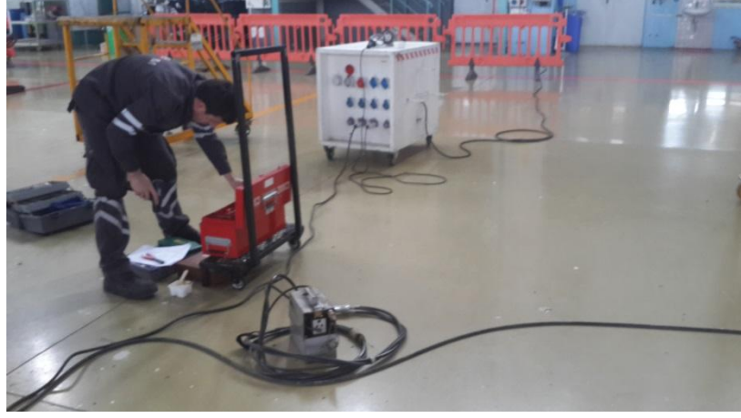
Şekil 18. Yerde dağınık vaziyette kabloların olması
