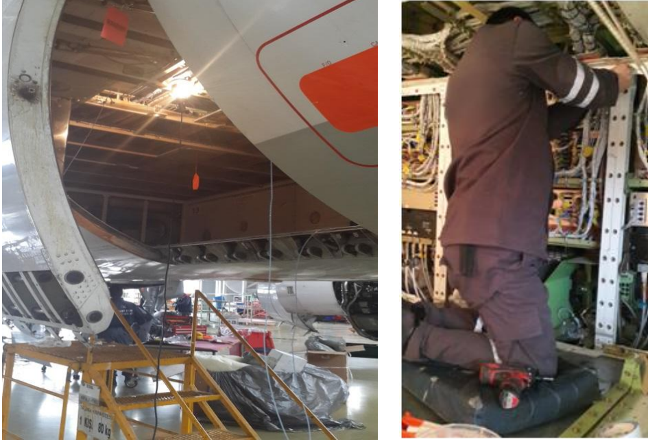
Şekil 24. Yetersiz aydınlatma nedeniyle çalışılan alanda gölgenin oluşması
