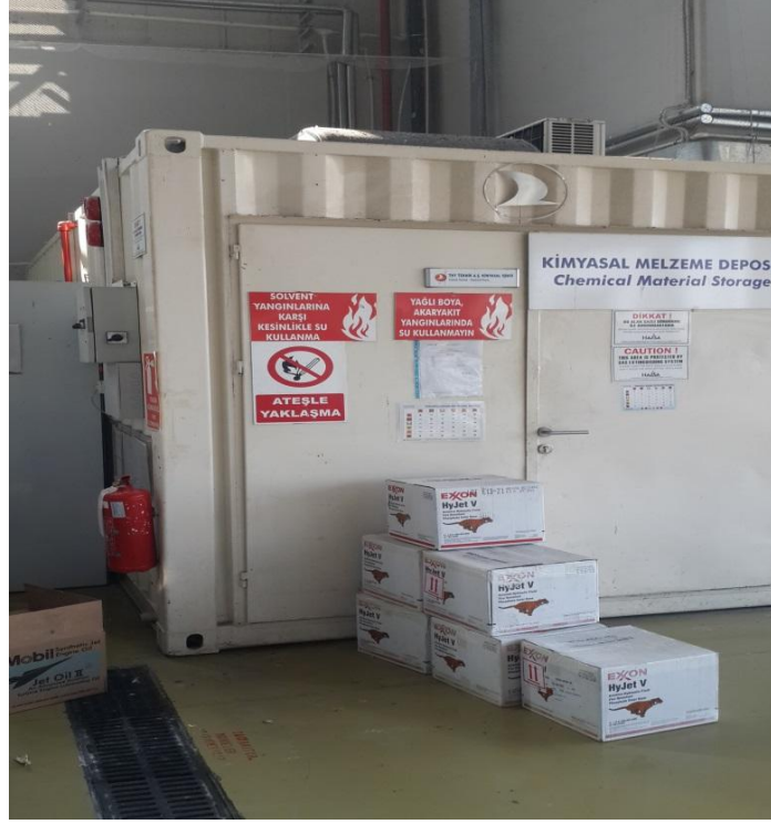
Şekil 40. Korunaklı kimyasal malzeme deposu
