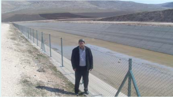
Resim 6. Tek tarafında güvenlik önlemi alınmış boş sulama kanalı-Şanlıurfa
