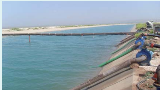
Resim 2. Güvenlik önlemi alınmamış dolu ve dinamo ile su çekilen su kanalı-Şanlıurfa
