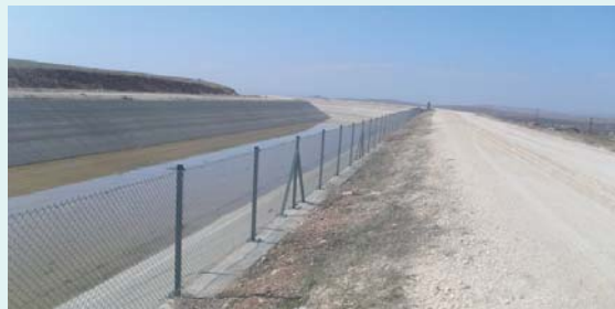
Resim 7. Tek tarafında güvenlik önlemi alınmış boş sulama kanalı-Şanlıurfa
