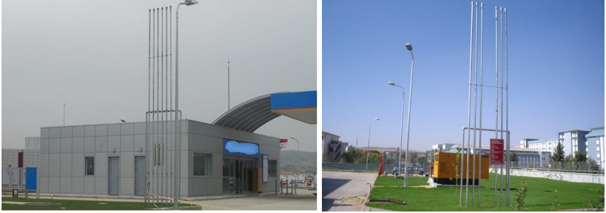
Şekil 10. İstasyonda yer alan havalandırma boruları (nefeslik)
