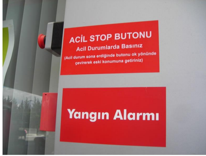
Şekil 13. Yakıt istasyonunda zorunlu olan acil durum butonu
