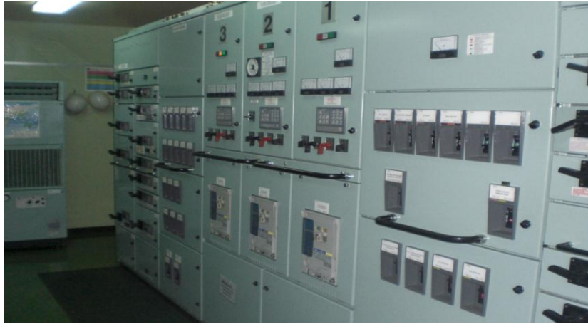
Resim 2.20. Düzgün Yalıtılmış, Sabitlenmiş ve Düzenli Elektrik Panosu Örneği
