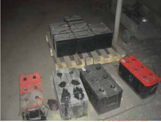
Akü sarj alanına havalandırma yapılmıştır.
