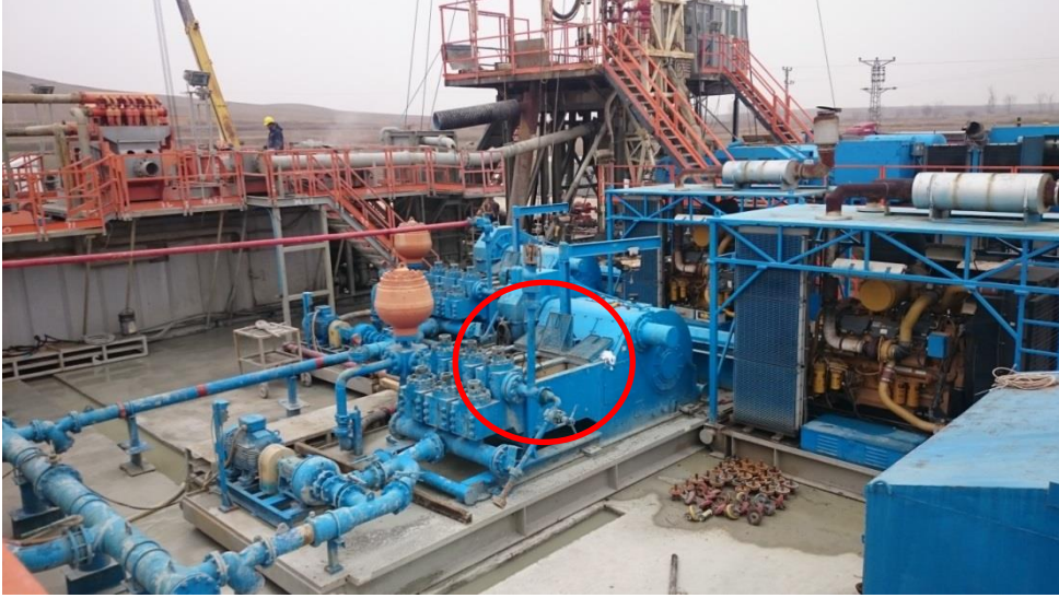
Resim 4.11. Çamur pompaları, motorlar
