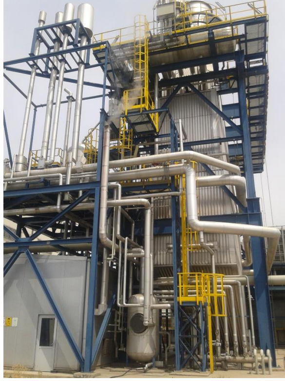
Şekil 15. 3. İşyerine Ait Su Borulu Buhar Kazanı
